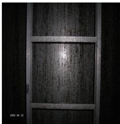
avant application (moisissures)
