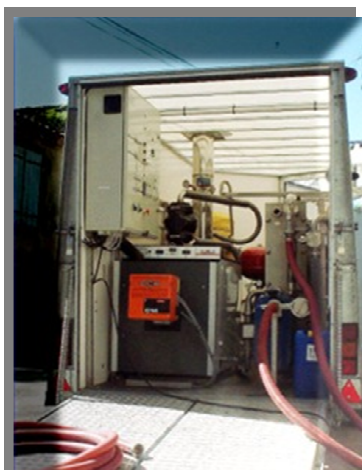
Fig. 4: Equipamiento técnico para la pasteurización flash
